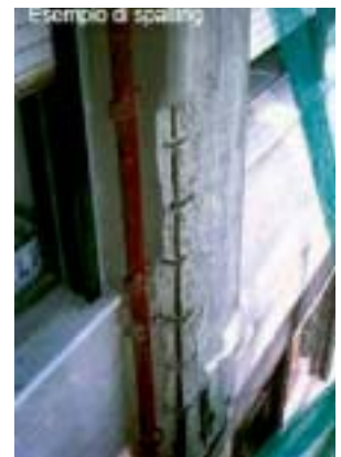
Corrosione di armatura unidirezionale del cemento armato
